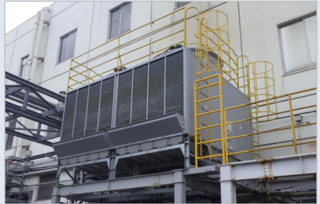
コンプレッサー用冷却塔
